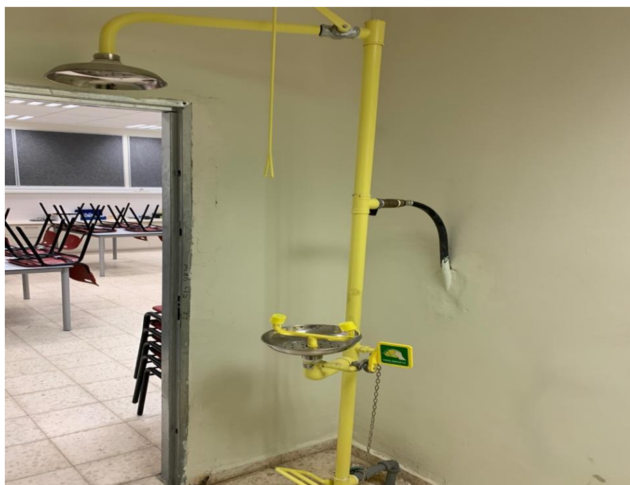
תיאור: מקלחת חירום לשטיפה נמצאת סמוך לחדר ההכנה
